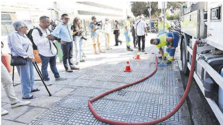
Acto de presentación de los depósitos instalados en el instituto de Sa Colomina.
